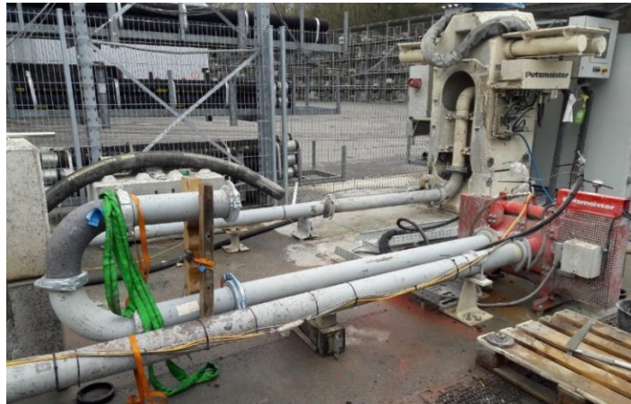
Abbildung 3-21: Rohrbogen an Rohrweiche [Foto: Mikhalev].
