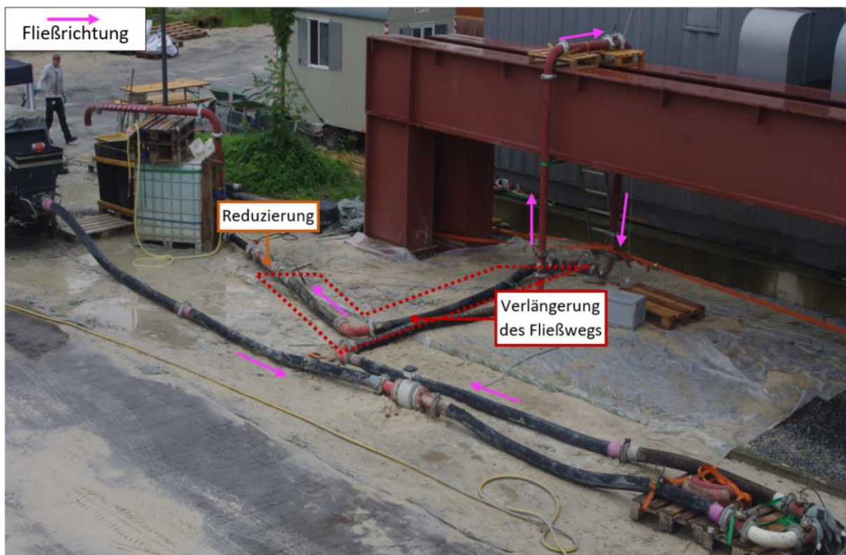
Abbildung 3-13: Foto der Pumpleitung 3 mit verlängerter Ruhe- und Konsolidierungsphase [Foto: Cotardo].
