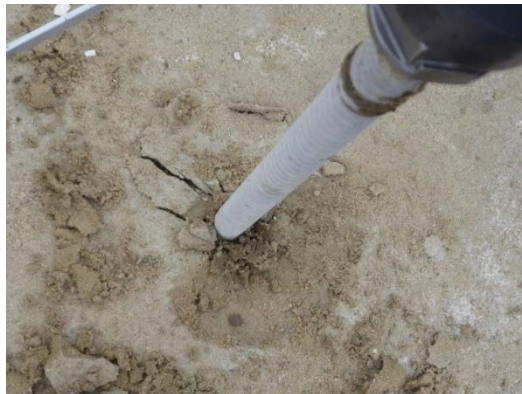
Abbildung 5-10: Exemplarische Darstellung einer oberflächennahen Störung während des Eindrehens
