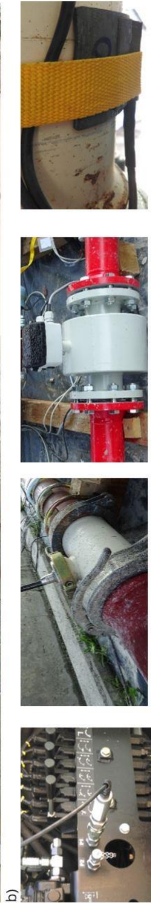
a) schematische Darstellung der Pumpstrecke b) Umsetzung der Pumpstrecke in die Praxis; eingebaute Sensoren: c) Drucksensor für die Pumpe, d) Drucksensor für die Rohrleitung, e) Durchflussmessgerät und f) Temperatursensor.
