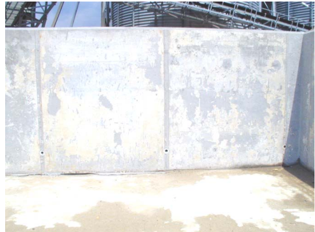
Bild C23: Betonage Abschnitt 1 – Einfluss der Schaloberfläche
