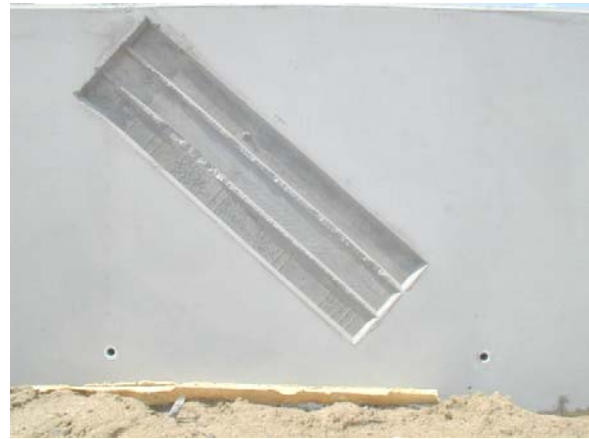
Bild C17: Betonage Abschnitt 1 – Einfluss der Schaloberfläche
