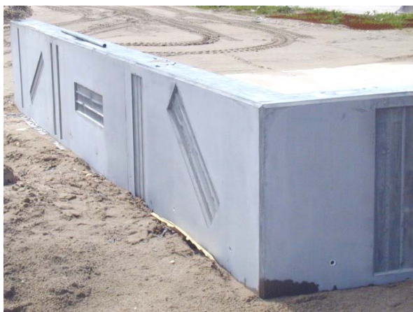
Bild C20: Betonage Abschnitt 1 – Einfluss der Schaloberfläche
