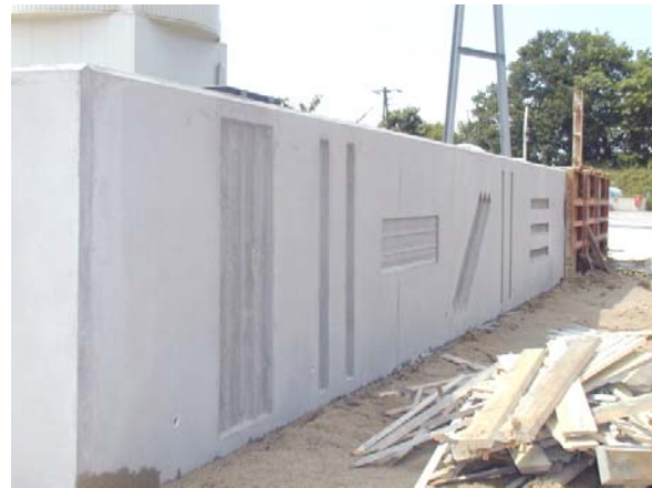
Bild C19: Betonage Abschnitt 1 – Einfluss der Schaloberfläche
