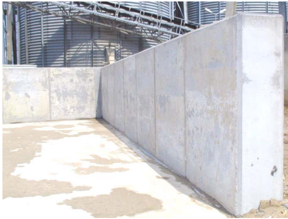
Bild C22: Betonage Abschnitt 1 – Einfluss der Schaloberfläche
