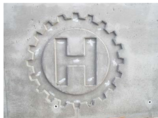
Bild C51: Probewand 3 - Ausschalen - Oberflächeneigenschaften
